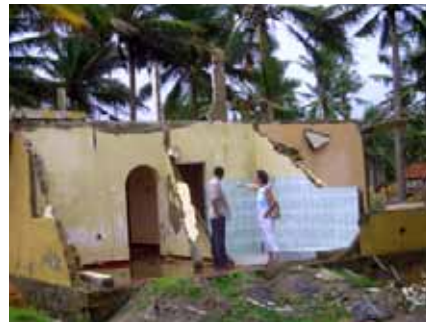
Ortsbesichtigung: Zerstörte Häuser
